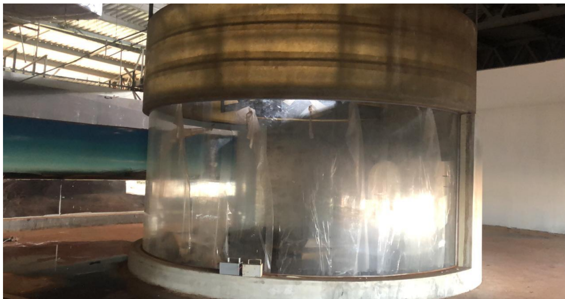
Tanque 02 – RESSURGÊNCIAS/ ASCENDENTES
